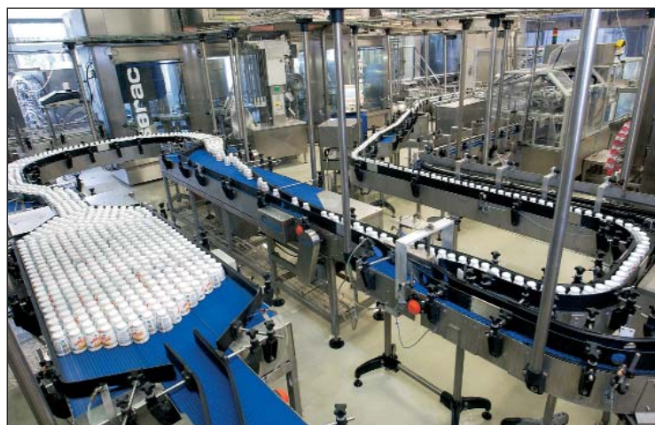
Beim Milchhof Meran soll eine zentrale Steuerung des Luftmanagements für einen kontinuierlichen Überdruck in den Produktionsräumen sorgen
